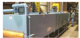
Calefactores de aire en procesos
